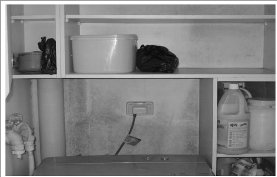
[그림 15] 발코니 창고 - 보조주방 발코니 결로 및 곰팡이 발생
