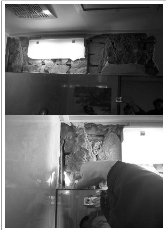
[그림 5] 조적벽 줄눈작업 불량, 외기 유입
