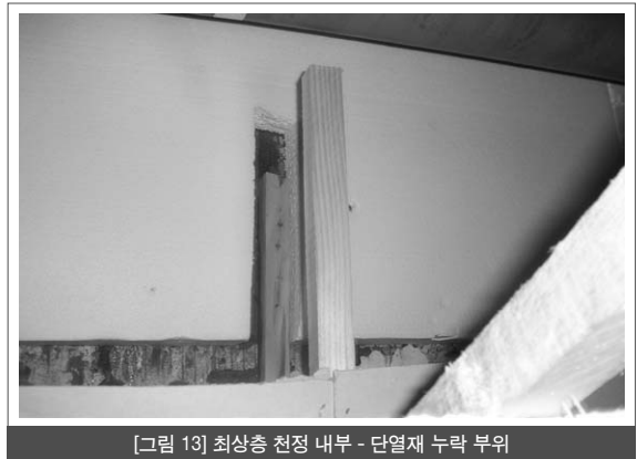
[그림 13] 최상층 천정 내부 - 단열재 누락 부위
