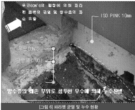
[그림 6] 파라펫 균열 및 누수 현황
