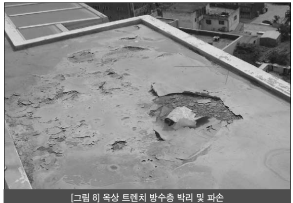
[그림 8] 옥상 트렌치 방수층 박리 및 파손
